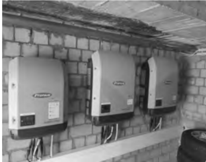
Drei Wechselrichter, die Gleichstrom von den Solarzellen in Wechselstrom für das Netz umwandeln
