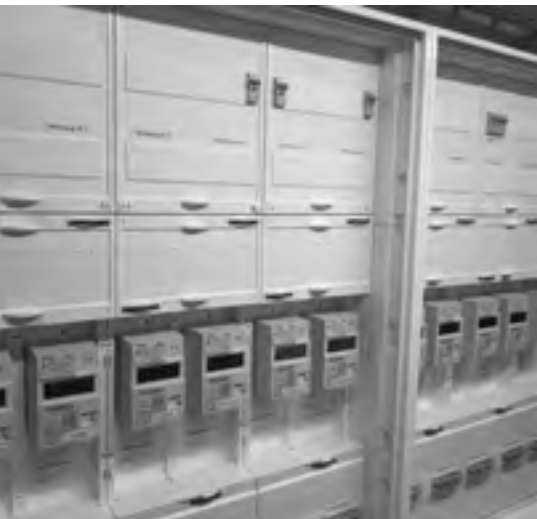
Die hausinternen Stromzähler der einzelnen Mietparteien
